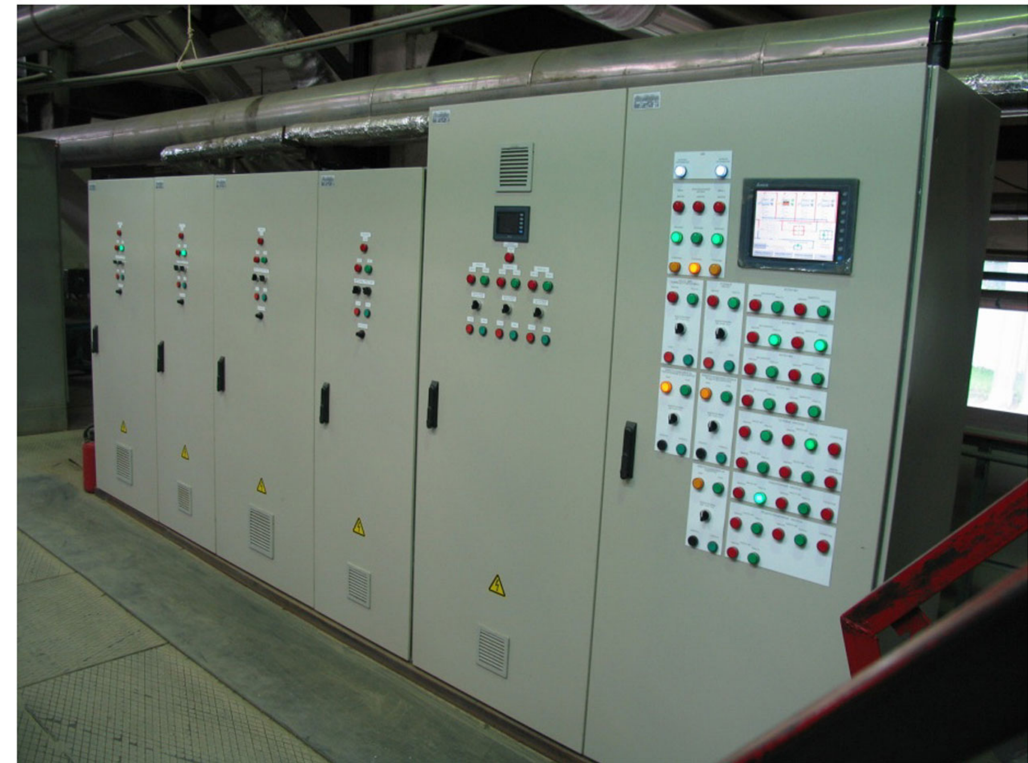
Шкаф вспомогательного оборудования котельной после модернизации
