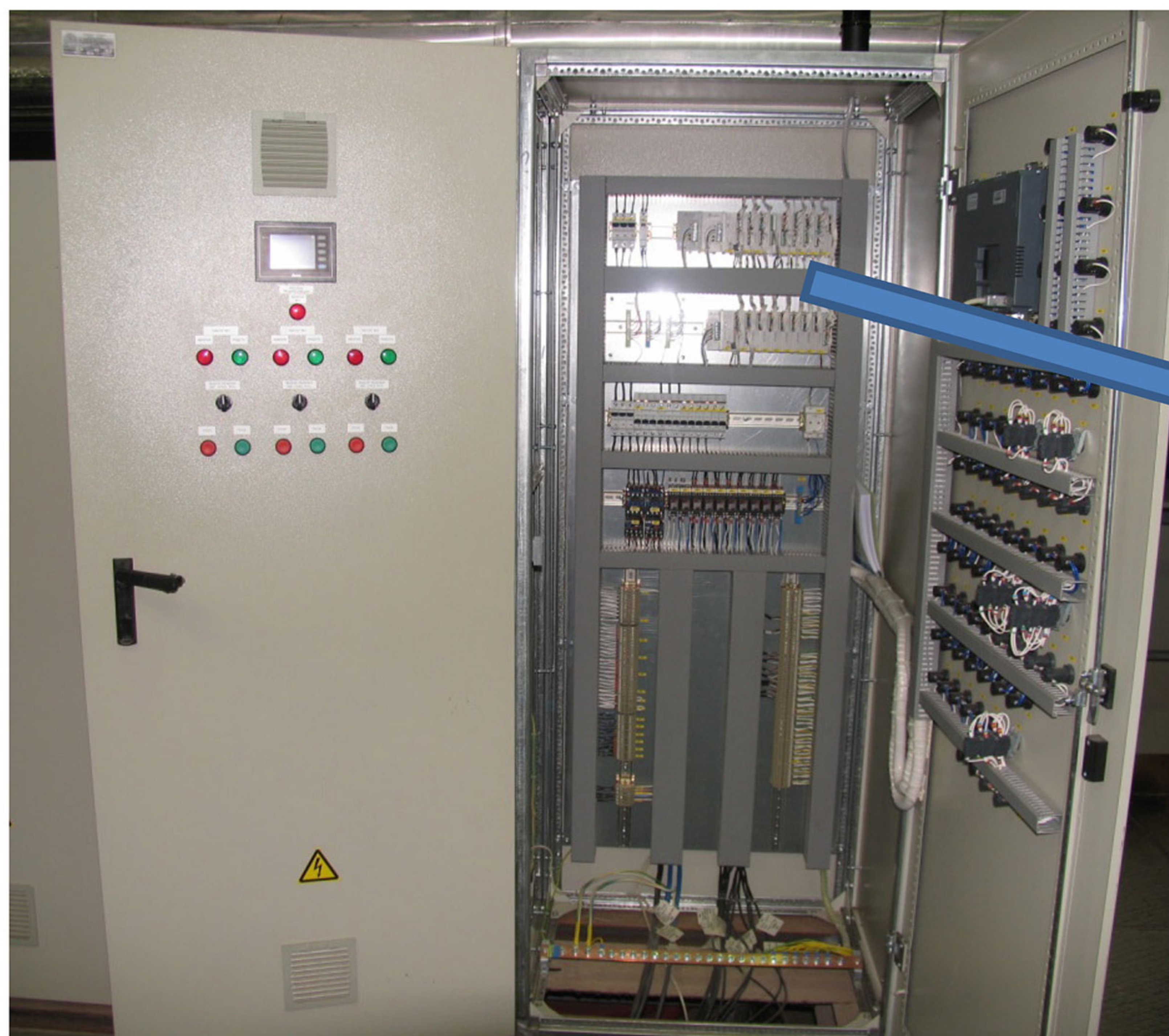
Шкафы управления вспомогательным оборудованием котельной
