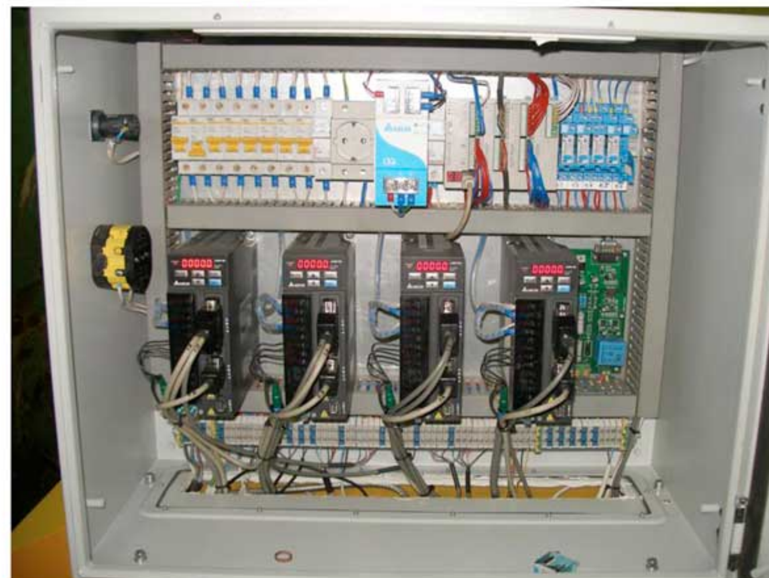
Шкаф управления с 4-мя сервоусилителями ASD-B2, контроллером DVP20SX2 с модулями расширения для управления движением сервоприводов
