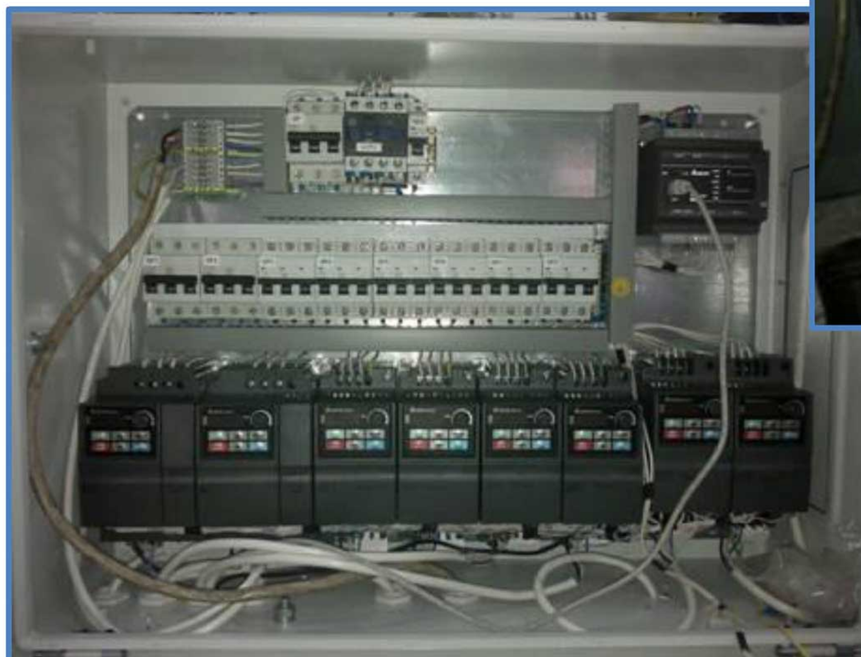
ПЧ VFD-EL и ПЛК DVP-ES2 в шкафу управления аппарата СД-600
